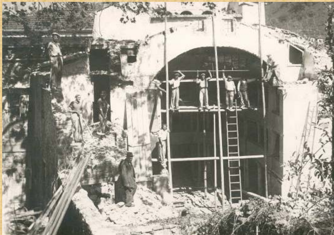
Demolizione del teatro dell'Accademia dei Ravvivati nei primi decenni del Novecento per la costruzione di villa Quartieri
